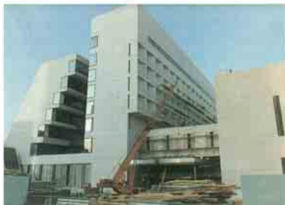
Auch im Innenausbau setzt KAEFER weltweit Akzente. So wurde jetzt ein Hotel- und Bürokomplex der „König-Feisal-Stiftung“ in der saudi-arabischen Hauptstadt Riad sach- und fachgerecht ausgestattet.
