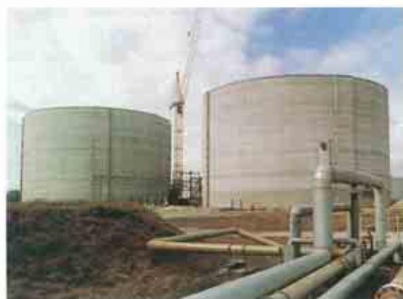
Wiederholt sind in der Vergangenheit die Fundamente von Flüssiggas-Lagertanks durch Oberflächenwasser feucht geworden. Betroffen waren davon in erster Linie die Druckringe aus Gasbeton. Durch das Gefrieren des eingedrungenen Wassers können mechanische Zerstörungen des Materials eintreten. Auch besteht die Gefahr eines Auffrierens der Fundamente. Bislang ließen
