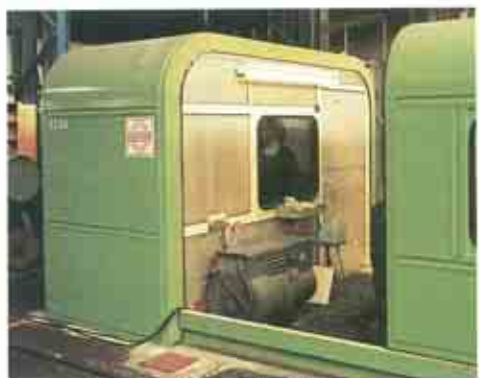
Verschiebbare Schallkapsel für Prüffeld von E-Lokomotivmotoren
