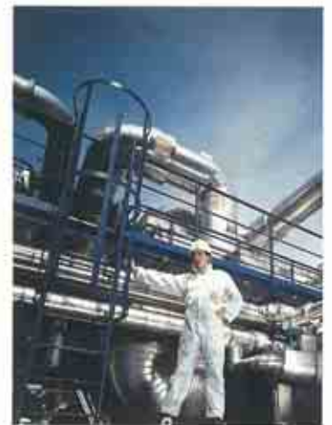
European Transonic Windtunnel; Kälteisolierung an der Dry Air Plant
