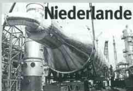
Das Foto zeigt eine der von KAEFER vorisolierten Kolonnen beim Transport. Die Kolonne C4703 ist 61 m hoch, in isoliertem Zustand 47 m lang und hat einen Durchmesser von 7 m. Die Isolierung und Blechabdeckung wurden innerhalb von nur 7 Tagen montiert.
